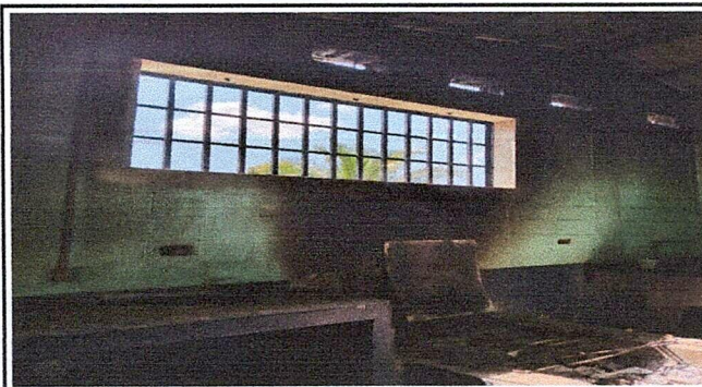
Foto 3: vano en cocina
