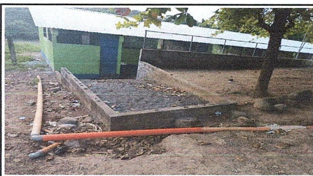
Foto 4: cambio de tubo solo en una parte
