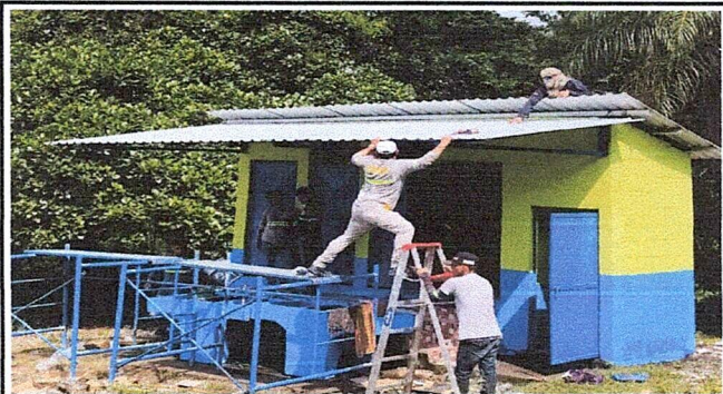
Foto 1: Se observa la necesidad de estructura de techo para pila y baños
