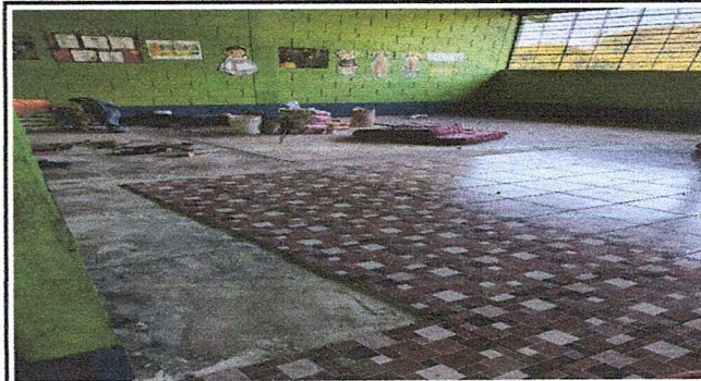
Foto 2: Se observa la necesidad de piso en aulas de modulo 2
