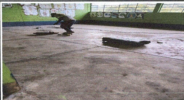
Foto 1: Se observa la necesidad de piso en aulas de modulo 2
