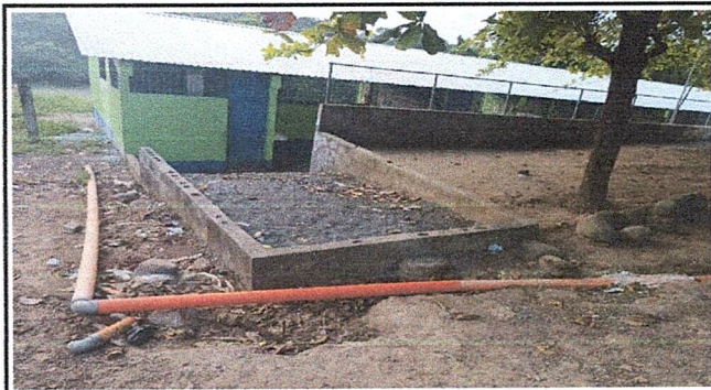
Foto 4: Se observa la necesidad e reparar drenaje de pila
