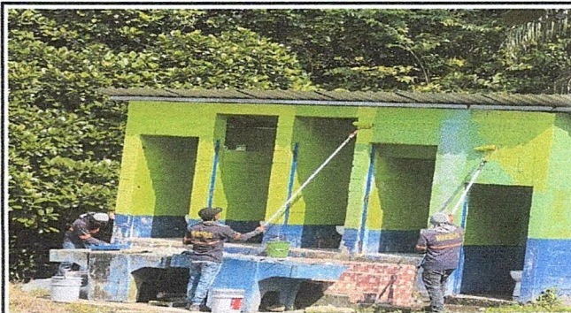
Foto 2: Se observa la necesidad de pintura en paredes de baños
