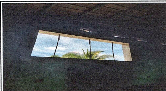
Foto 3: Se observa la necesidad de una ventana en cocina
