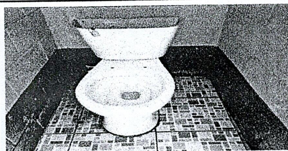
Foto 6: Se observa la necesidad de sustituir sanitarios
