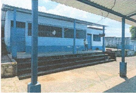
Foto 7: Referencia renglón 3.3 (suministro de baranda de metal para corredor, aula 1).
