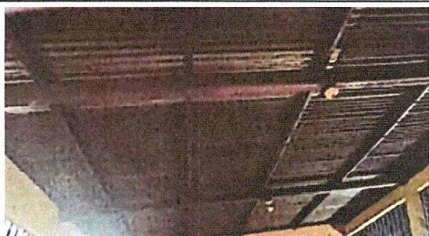
Foto 3: Sustrución de lámina, cableado eléctrico y costaneras en mal estado
