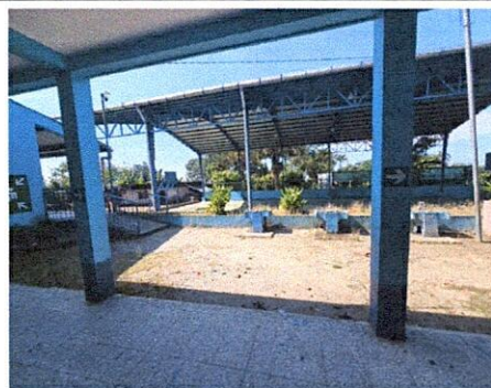
FOTO 6: Sustrucción de losa de patio de concreto t: 0.10
