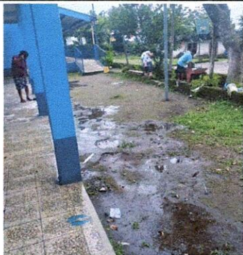
FOTO 1: Sustrucción de losa de patio de concreto t: 0.10
