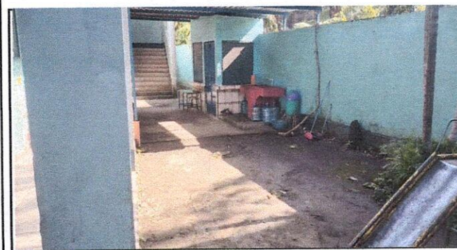
Foto 11: Se observan patio de tierra, al momento en que cae la lluvia se hace charco y ya no se puede caminar, es necesario la fundicion de torta de concreto
