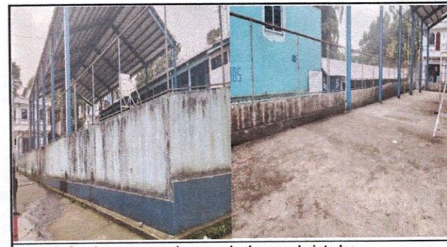
Foto 12: Se observan paredes manchadas y mal pintadas
