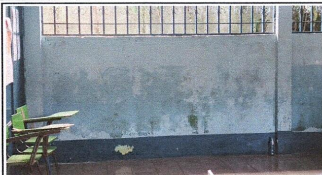
Foto 1: Se observan las paredes en mal estado debido a la humedad, en las 3 aulas de la planta alta, en algunos puntos el repello se esta levantado debido al problema
