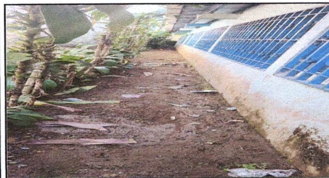
Foto 5: Se observa la nesecidad de levantar bloqueado de concreto con sus respectivas columnas y soleras, para garantizar la proteccion de las paredes de las aulas en la planta alta de la escuela
