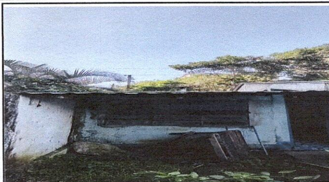
Foto 8: Se observa la ventana de la cocina de primaria en mal estado, por tal motivo se ve la necesidad de realizar el cambio por una nueva
