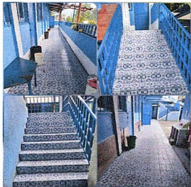
Foto 07: Suministro de piso antideslizante en módulo de pasillo frente a aulas
