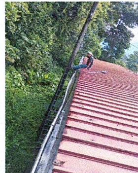
Foto 4: Mantenimiento de canal de metal + bajadas de agua pluvial pvc 3"
