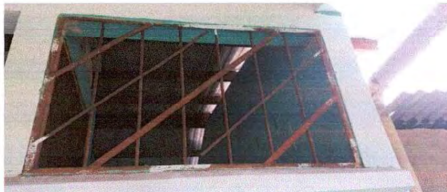
Referencia renglón 2.1 (mantenimiento balcón baño).
