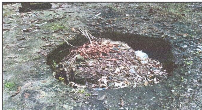
Foto 4: se realizara el manteniminto a fosa septica que se encuentra colapsado.
