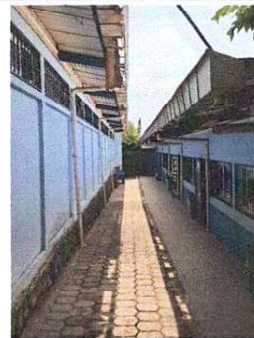
FOTO 4: Suministro de balcones
