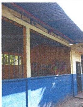
Foto 3: Inadecuada colocación de block sobre solera corona
