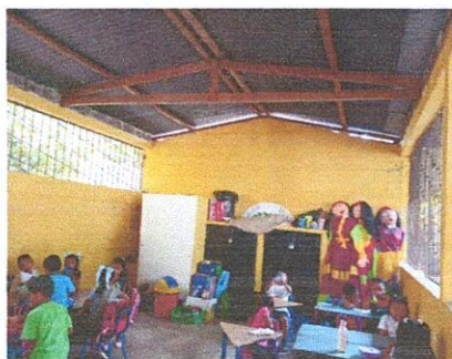
Foto 2: Estructura de sujeción de madera inadecuado y deteriorada por factor tiempo. La cubierta de lámina zinc presenta perforaciones en varios puntos.
