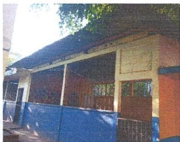
Foto 1: Puerta de ingreso tipo reja en mal estado, por factor tiempo y uso.
