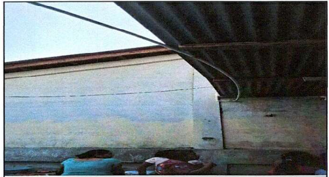
Foto 4: Referencia renglón 4.1 Sustitución de estructura de soporte de madera, por metal
