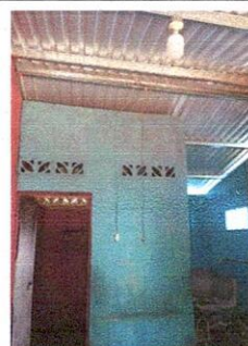
Foto 2: Instalaciones eléctricas inadecuadas, incluyendo cableado deficiente, alturas incorrectas de tomacorrientes y colocación inadecuada de apagadores.
