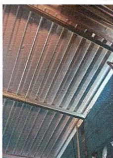
Foto 1: Cúbierta de lámina troquelada calibre 28, presenta perforaciones y ondulaciones debido a instalaciones inadecuadas. La estructura de sujeción está compuesta por costaneras galvanizadas milimétricas, con empalmes incorrectos en zonas críticas.
