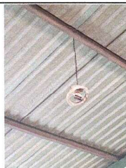
Foto 4: Las lámparas han sufrido un deterioro significativo debido al prolongado uso, lo que ha afectado su rendimiento y eficiencia.
