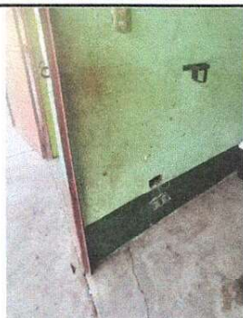
Foto 7: Los tomacorrientes están inoperativos y en mal estado debido al desgaste.
