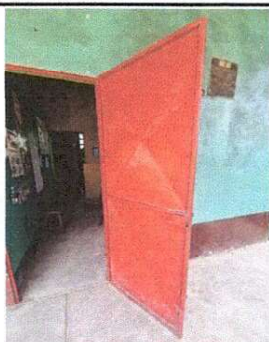
Foto 1: La puerta presenta corrosión en la zona inferior debido a la exposición prolongada a la humedad y sales.
