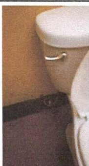
Foto 3: Los baños están inutilizados debido a un problema en el sistema de drenado de agua, que impide la correcta eliminación de residuos.
