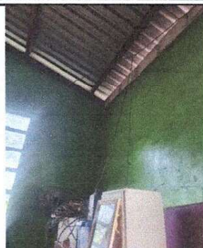
Foto 8: El cableado no tiene protección de ducto, lo que aumenta el riesgo de accidentes para los niños.
