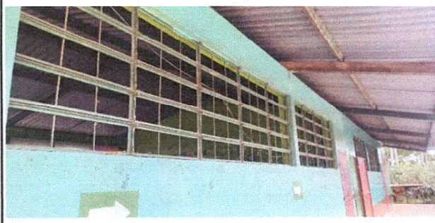
Foto 12: Las paredes de exteriores e interiores de establecimiento educativo se encuentran mañadas por el deterioro de la pintura, dando un aspecto de abandono a las paredes.
