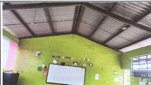
Foto 10: El cableado no tiene protección de ducto, lo que aumenta el riesgo de accidentes para los niños.
