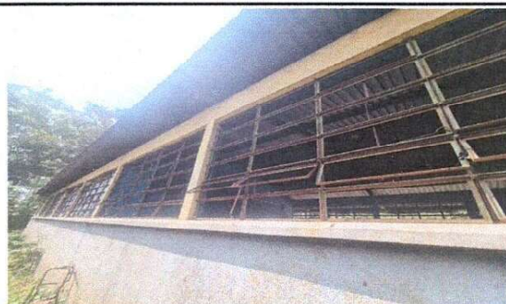
Foto 2: Las ventanas han sufrido deterioro, con ausencia de vidrio y corrosión en el marco de hierro.
