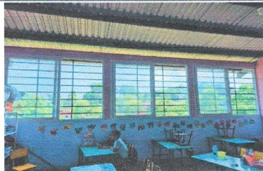
Foto 2: REFERENCIA RENGLO 1.4 (SUSTITUCIÓN DE VENTANAS)
