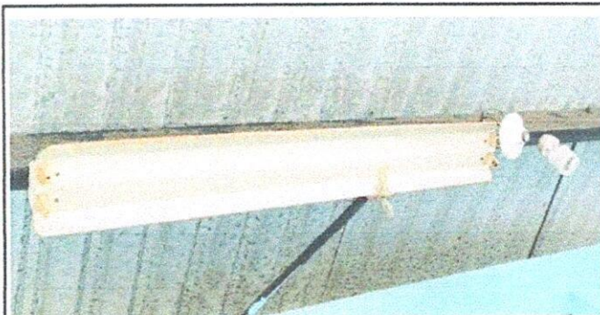
Foto 3: Referencia renglón 1.5 (Sustitución de lamparas 2 x 40 por focos LED)
