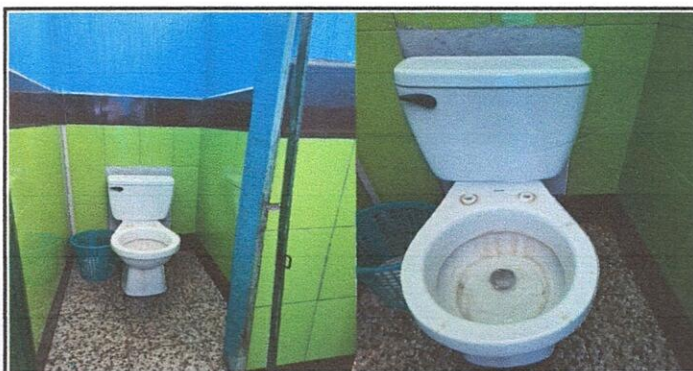
Foto 5: Sustrucción de accesorios en sanitario (contra llave, tubo de abasto, flappers y tapadera)
