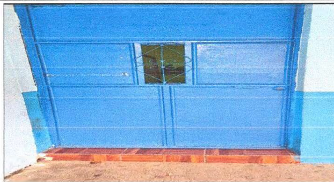
Foto 2: Sustrucción de puerta de metal modulo 2 de 0.98m x 2.20m
