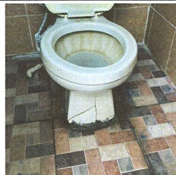
Foto 4: Sanitarios en mal estado.
