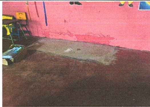
Foto 2: Piso en mal estado del nivel preprimario.
