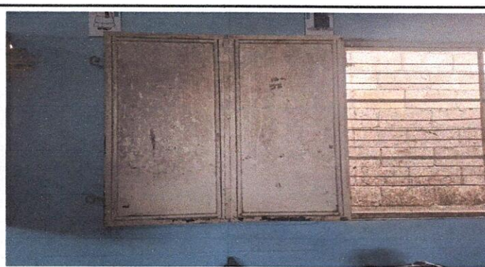
Foto 4: Ventanas de aulas en mal estado
