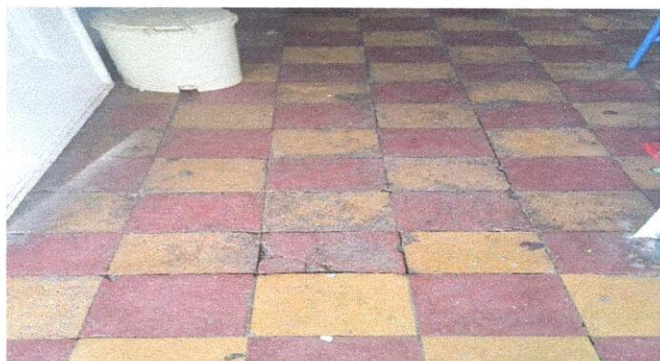
Foto 1: PISO DE AULAS EN MAL ESTADO
