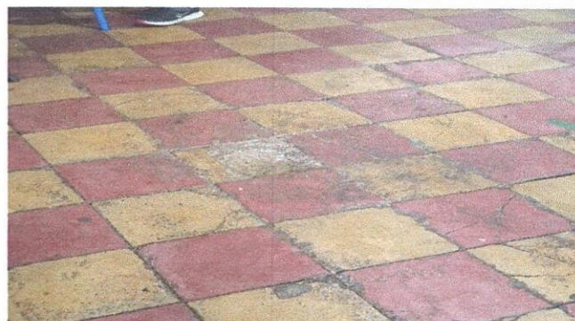
Foto 2.: Piso de corredor en mal estado
