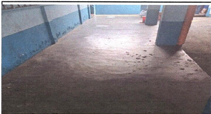
Foto 3: Piso de corredor en mal estado
