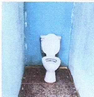
FOTO 1: Sustrucción de accesorios de inodoros
