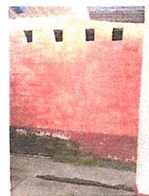
FOTO 6: REPELLO EN MUROS INT/EXT EN COCINA
