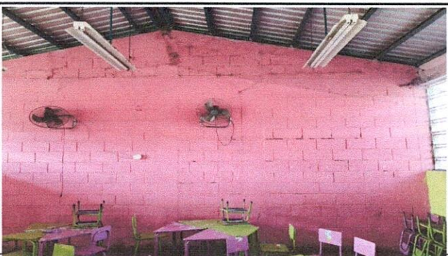
FOTO 3: PINTURA EN MUERO INTERIOR
