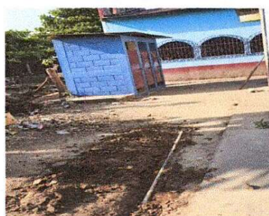
FOTO 4: RED DE AGUA POTABLE HACIA BAÑOS
