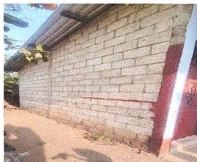
FOTO 2: REPELLO + CERNIDO EN MUROS
