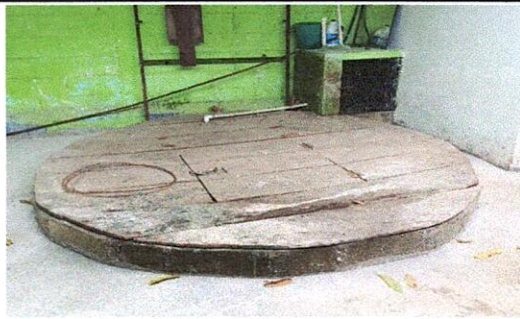
FOTO 2: TAPADERA DE METAL DE 2.50 DE DIAMETRO PARA CISTERNA
