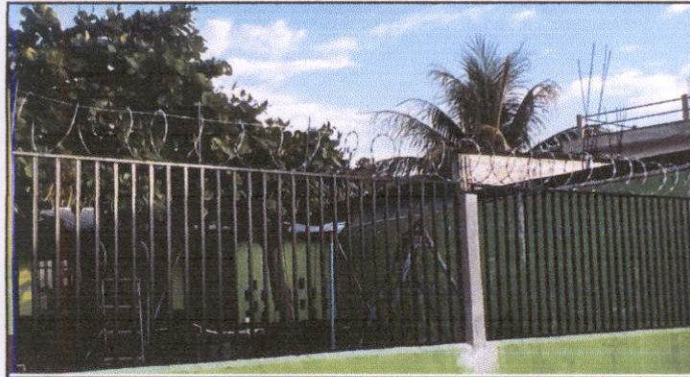
Foto 1: Sustrucción de tubo hg y malla galvanizada, por balcones tipo barrote
