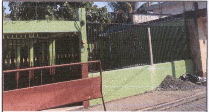
Foto 2: Sustrucción de tubo hg y malla galvanizada, por balcones tipo barrote
