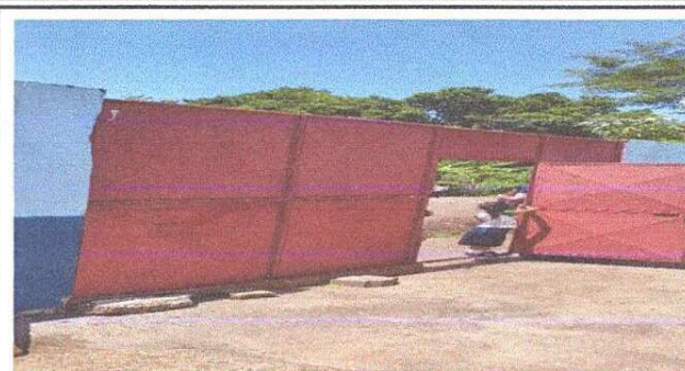
Foto 2: Sustrucción de portón de por portón corredizo de estructura metálica
