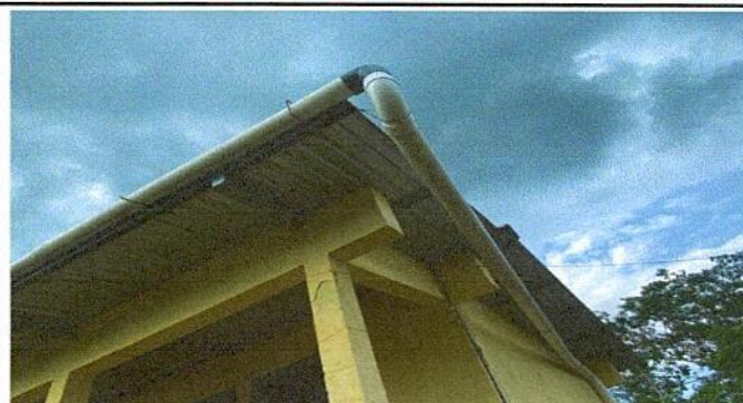
Foto 2: Suministro de bajada pluvial de 6'
