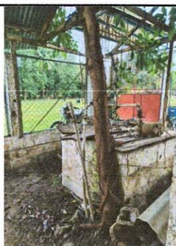
FOTO 3: TAPADERA DE POZO DE METAL
