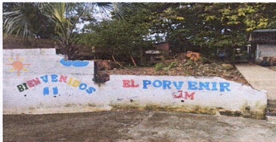
Foto 9: Referencia renglón 2.5 (suministro de baranda de metal para protección en muro de ingreso secundario).
