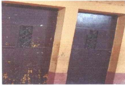
FOTO 1: Sustrucción de puertas en mal estado
