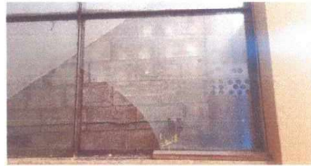
FOTO 2: Ventanas en mal estado, sustituir por vidrios nuevos.
