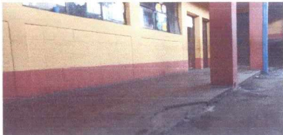
FOTO 3: piso de torta en mal estado. Sustituir por piso cerámico dentro de las aulas y el corredor.
