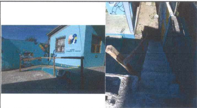
Foto 3: Colocar barrandas a la rampa y a las gradas para mayor seguridad de los niños. Mayormente a los que presentan discapacidad física motora.
