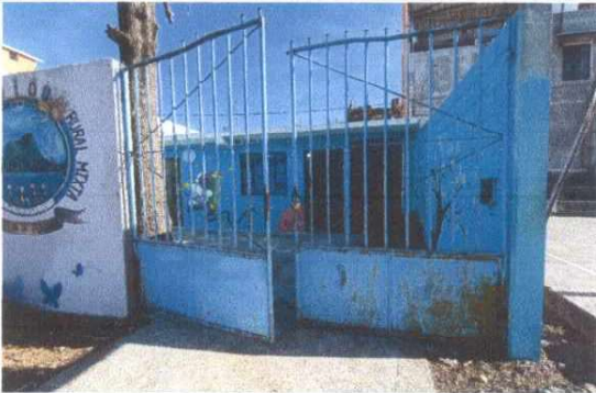
Foto No. 1: Entrada principal a la Escuela. Sustitución del portón actual por estado de deterioro (oxidación de la estructura).
