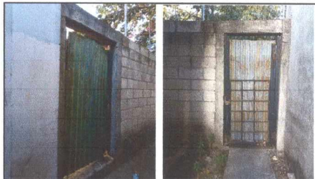
Foto 4: Cambio de puerta de la segunda entrada de la escuela. La actual esta en mal estado.
