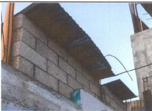
Foto 5: Techo deteriorado de la Dirección y bodega.
