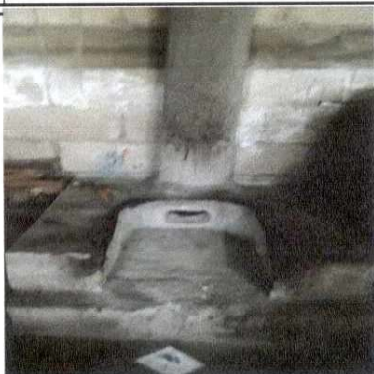
Foto 1: planchas en mal estado
