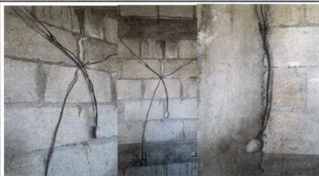
Foto7: falta sistema electrica
