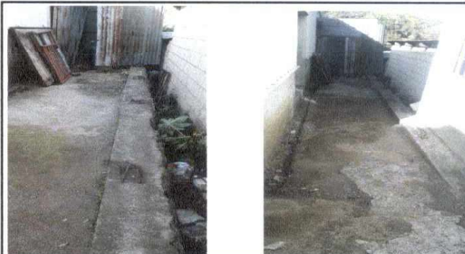
Foto 8: falta muro de contencion
