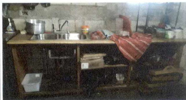
Foto 2: gabinetes en mal estado
