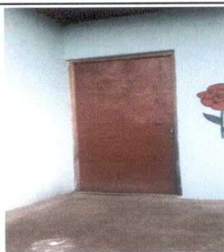
Foto 5: puerta en mal estado
