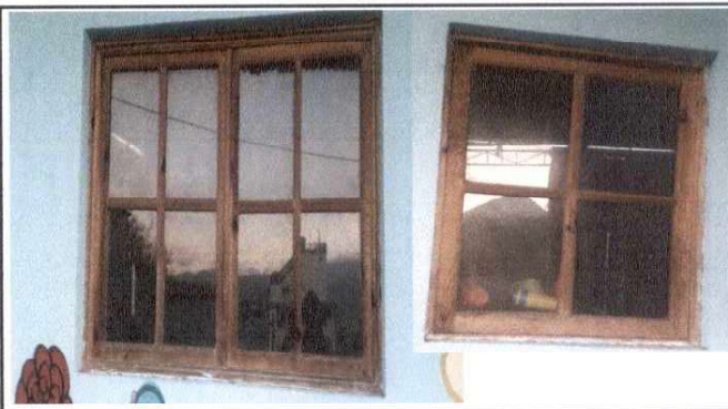
Foto 4: ventana en mal estado
