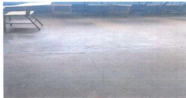
Foto 4: Tambien en esta foto se ve la teterioracion del piso del cuarto aula, por lo que si son necesarios remodelarlas.
