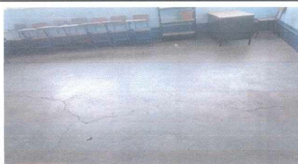
Foto 2: En esta foto se ve la imagen del piso deteriorado del segundo aula.
