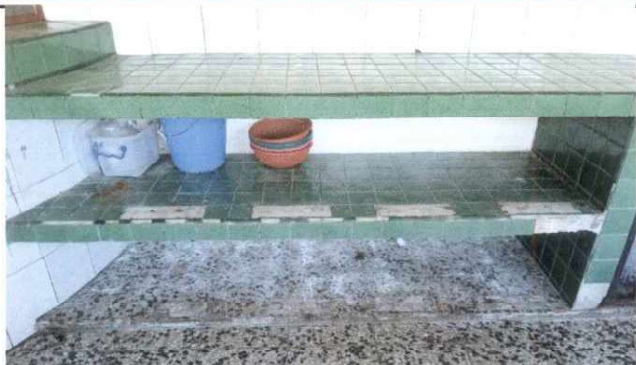
Foto 1. El lugar para guardar los utensilios de cocina, está deteriorado y con mucha humedad.
