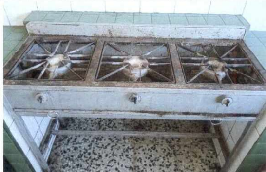
Foto 3. La estufa en mal estado, la llama que saca ya es mínima.
