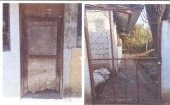
FOTO 4. PUERTA Y PORTÓN DETERIORADA
