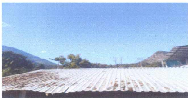
FOTO1. LÁMINA EN MAL ESTADO
