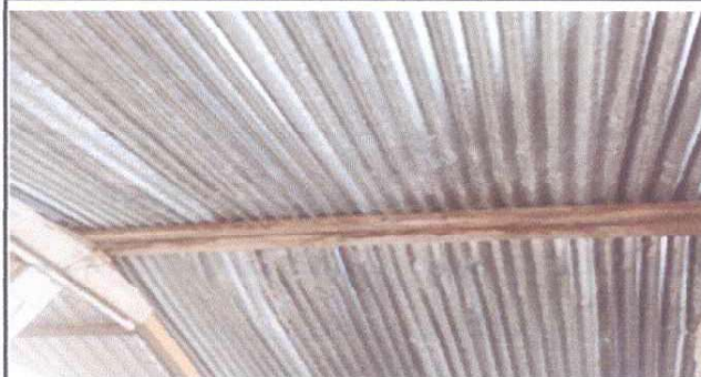
FOTO. 2 ESTRUCTURA DE TECHO EN MAL ESTADO
