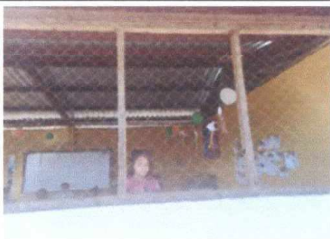
FOTO 3. VENTANAS EN MAL ESTADO
