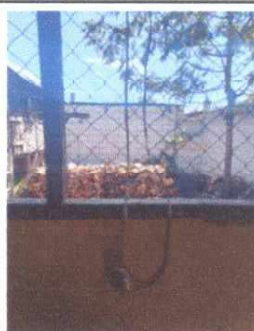
FOTO 6. SISTEMA ELECTRICO EN MAL ESTADO
