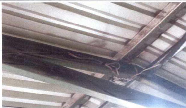
Foto 3: cable eléctrico en mal estado dentro del aula.
