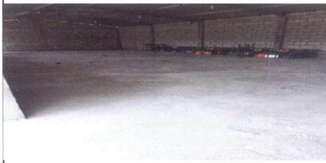
Foto 2: El piso de torta de concreto deteriorada dentro del aula.
