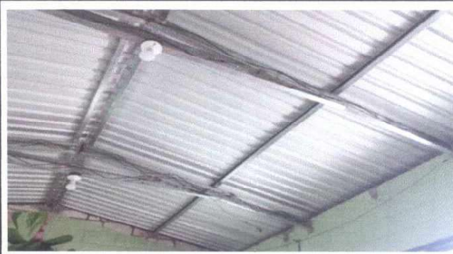
Foto 4: Focos pequeños en mal estado del del aula.
