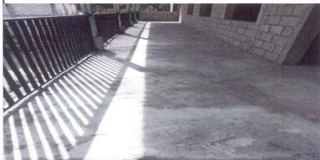
Foto 1: El piso de torta de concreto deteriorada en el corredor del aula.
