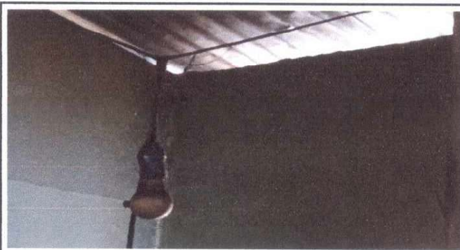
Foto 3: Se observa en el área de cocina, por no tener una instalación formal de la electricidad, por tal motivo se necesita instalación de sistema eléctrico.
