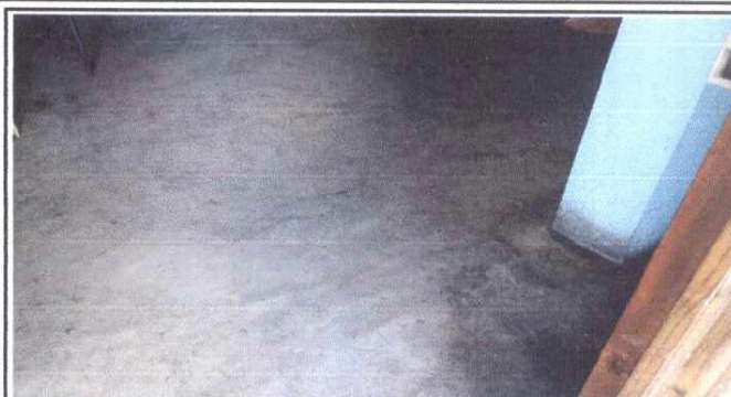
Foto 2: Se observa en el área de cocina el deterioro del piso, se muestra la necesidad de realizar el cambio.
