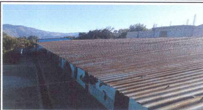
Foto 1: Se observa en el Módulo 3 en el área de techado, se muestra la necesidad de cambiar el techado de las aulas.
