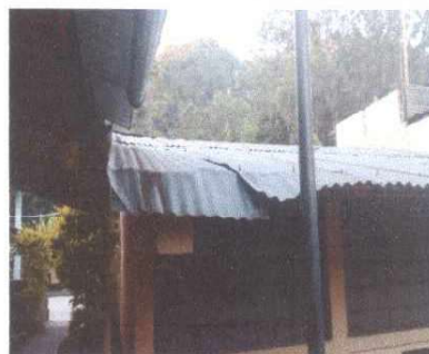
Foto 4: Techado en mal estado
