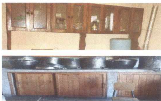
Foto1: Gabinete de cocina en mal estado
