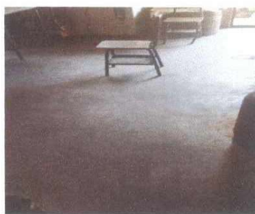
Foto 2: Piso de cocina en mal estado
