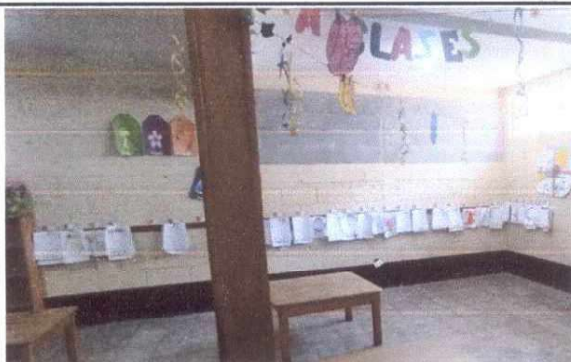
Foto 3: Muros presentan aspecto inacabado, por lo que se aplicara repello y cernido
