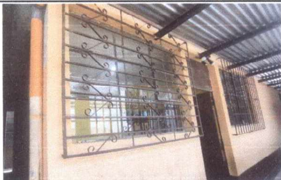
Foto 1: Balcones de ventanas deterioradas
