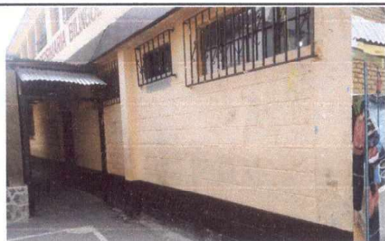
Foto 5: Muros presentan aspecto descuidado por lo que se requerira acabado en pintura posterior al repello
