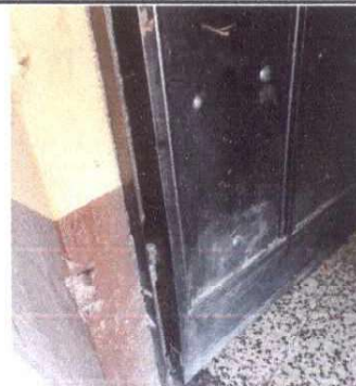
Foto 2: Puertas requieren mantenimiento
