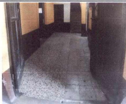
Foto 4: Piso desgastado en aulas, pasillo y modulo de gradas
