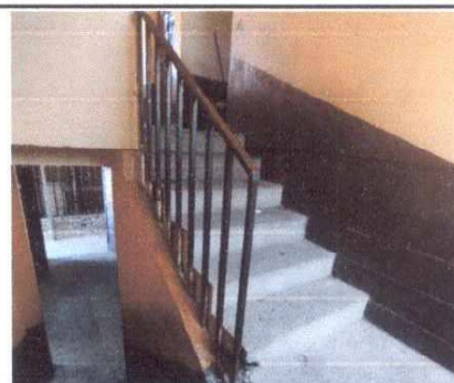
Foto 6: Baranda de modulo de gradas deteriorada
