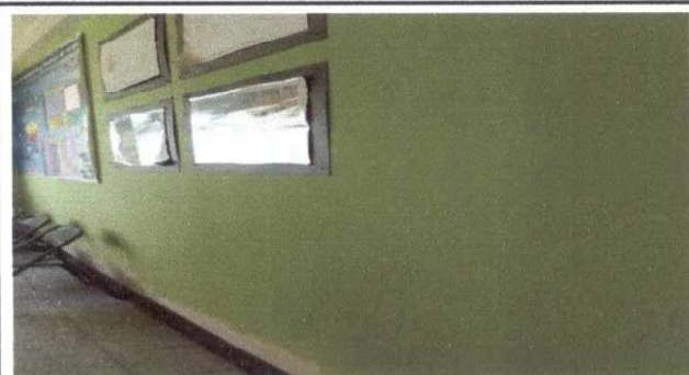
Foto 1: MURO SUSTITUIDA POR BLOCK REFORZADO EN MAL ESTADO
