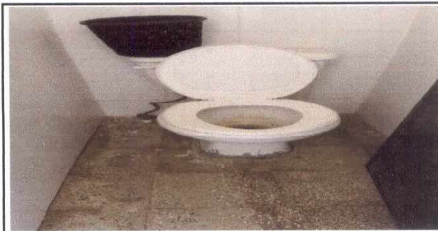
Foto 6: SERVICIOS SANITARIAS EN MUY MALAS CONDICIONES
