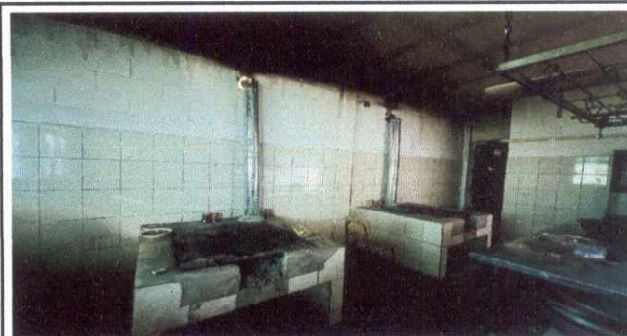
Foto 4: ESTUFAS DE COCINA EN MUY MALAS CONDICIONES Y DETERIORADAS
