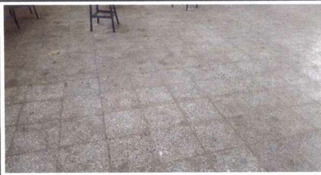
Foto 2: PISO DETERIORADO EN CONDICIONES PESIMAS
