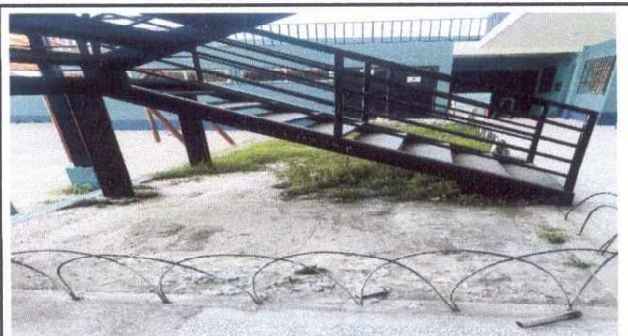
Foto 3: LOSA DE PATIO EN CONDICIONES MUY DETERIORADAS
