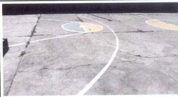
Foto 2: LOSA EN MAL ESTADO QUE SERA SUSTITUIDA
