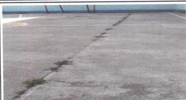
Foto 1: ÁREA A REMOZAR CON LOSA DE PATIO, LA CUAL SE ENCUENTRA EN MAL ESTADO
