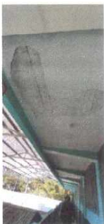
FOTO 1: Repello de la terraza ya deteriorada, se necesita reparar
