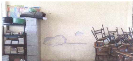
FOTO 2: en algunas de las aulas se necesita reparar con el repello.
