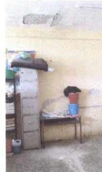
FOTO 4: En las aulas ya se está cayendo el repello del cielo.
