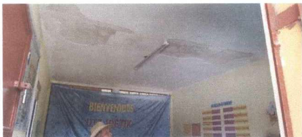
FOTO 3: La oficina de la Dirección de la escuela se empeora por el cielo del repello que se encuentra muy mal.
