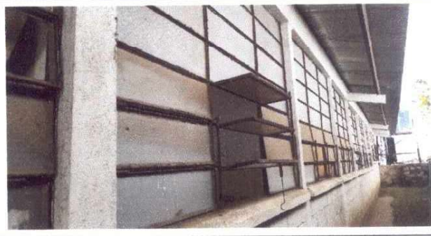
Foto 4: VENTANAS CON MUCHOS VIDRIOS ROTOS Y METAL CON MUCHA CORROSIÓN EN MAL ESTADO
