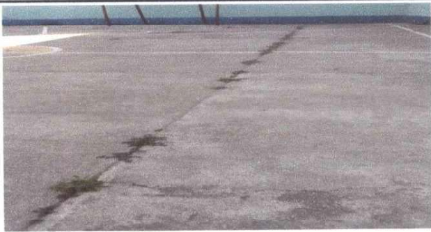
Foto1: EL PATIO CIVICO SE ENCUENTRA EN MAL ESTADO
