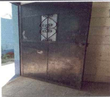
Foto 3: PUERTAS DE BODEGA Y 2 AULAS EN MALAS CONDICIONES Y CON MUCHA CORROSIÓN
