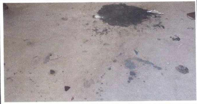
Foto 2: PISO DE SALON SE ENCUENTRA DETERIORADO
