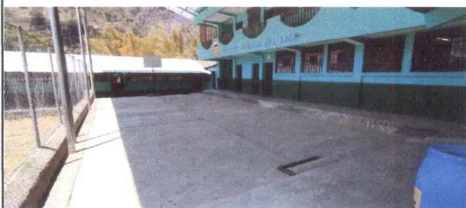
FOTO 3: Losa de patio en mal estado.
