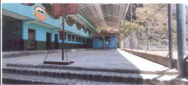
FOTO 4: Otra perspectiva de Losa de patio en mal estado.
