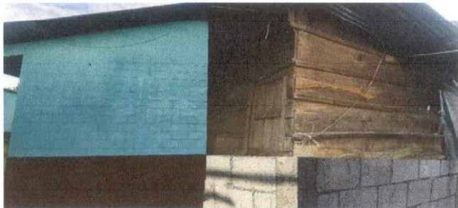
Foto 1: Muro cocina incompletos
