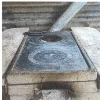
Foto 2: Plancha de cocina en mal estado
