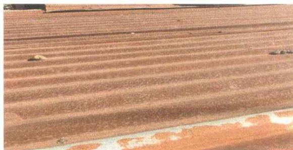
Foto 4: Laminas en mal estado
