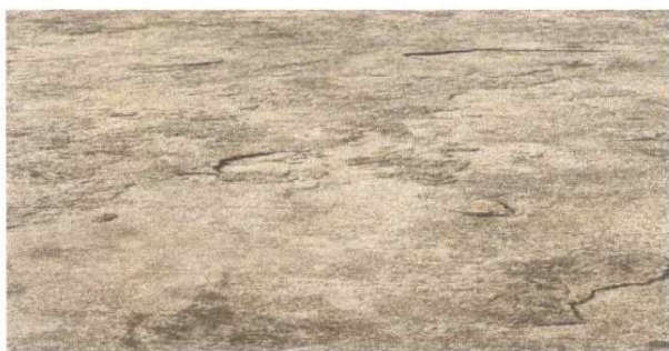
Foto 5: Piso en mal estado
