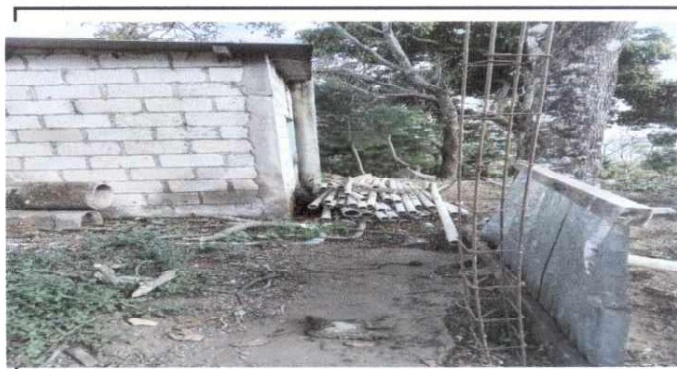
Foto 4: circulación del lado sur con láminas en mal estado
