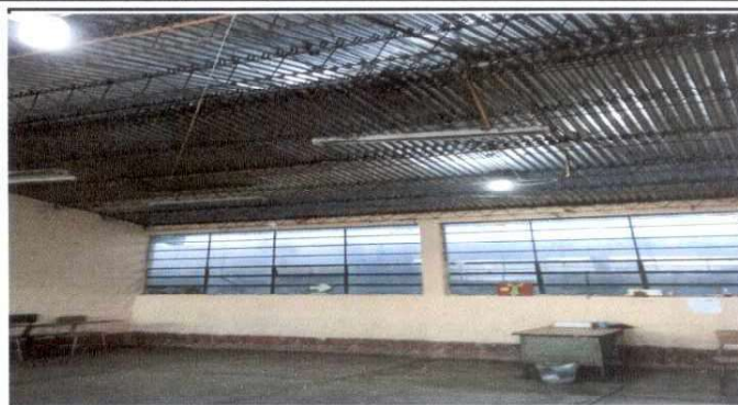
Foto 2: bigas de hierro en mal estado
