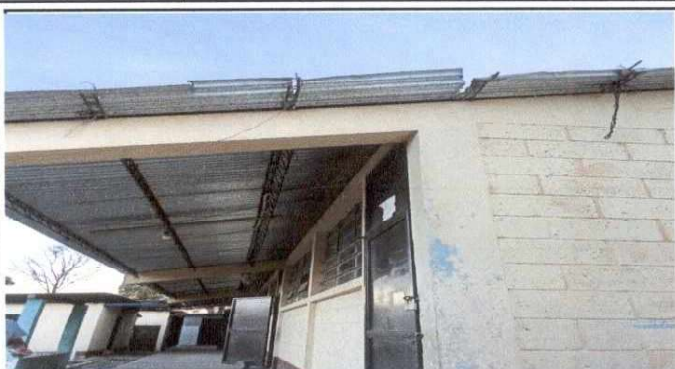
Foto 1: Techo de láminas rotas.
