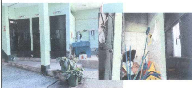
Foto 2: Baños en mal estado y fuera de servicio primer nivel.
