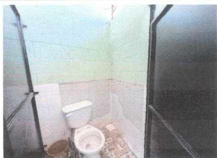
Foto 3: Sanitarios y azulejos en mal estado
