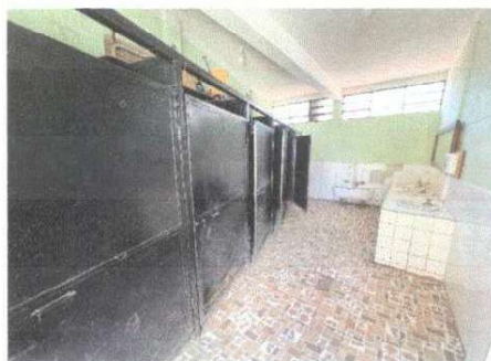
Foto 4: Sanitarios, mingitorios y lavamanos en mal estado.
