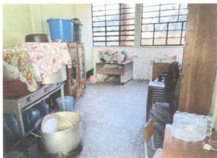
Foto 1: Poyo y piso de la cocina en mal estado.
